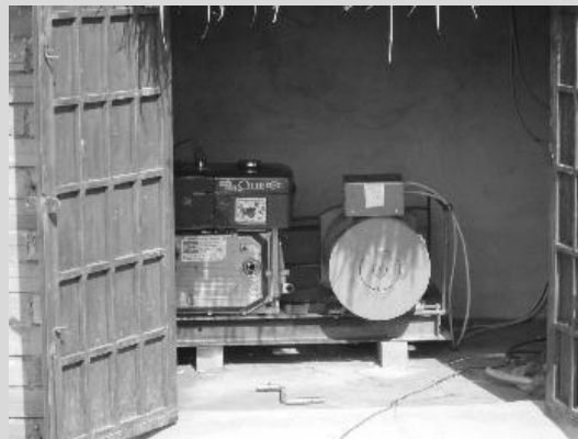
Grupo generador con biogás.
